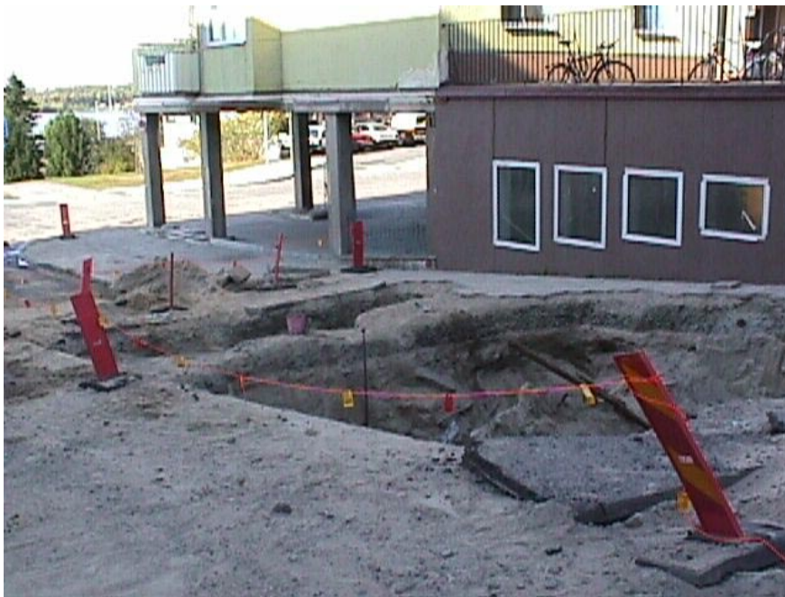
Sanering av en nedlagd bensinstation. Vid den här anläggningen fanns drivmedel kvar i de nedgrävda cisternerna. Marken kring tankningstället under pelarna är också förorenad.
